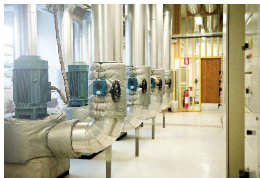
Fra pumperummet på Buen-centralen
